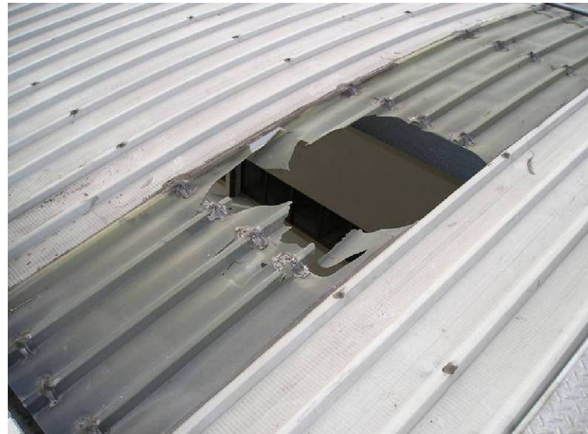
輕鋼板間採光之塑膠片被踏穿破裂情形
