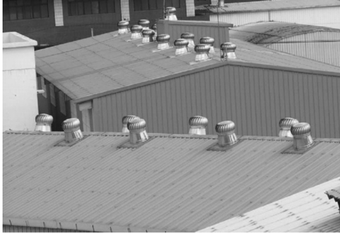
工業區廠房屋頂普遍裝設抽風機等設施
