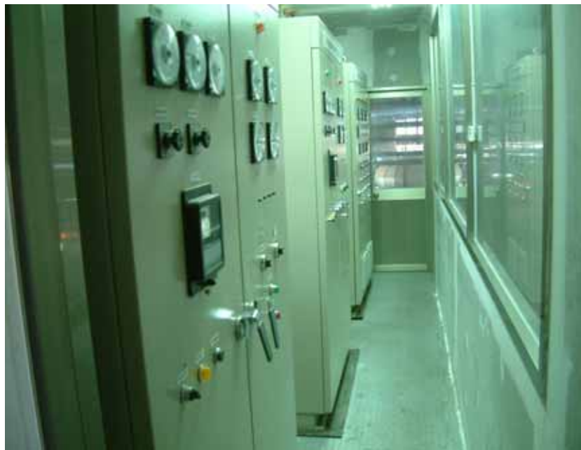
圖 7.9 玻璃窯爐之儀表控制室
