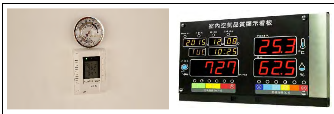
圖4-5 室內空氣品質自動監測設施
