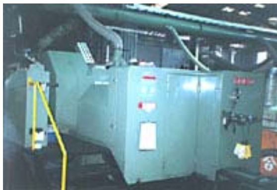
圖 3.12 製程收集之油霧送往低電壓靜電集塵機處理
