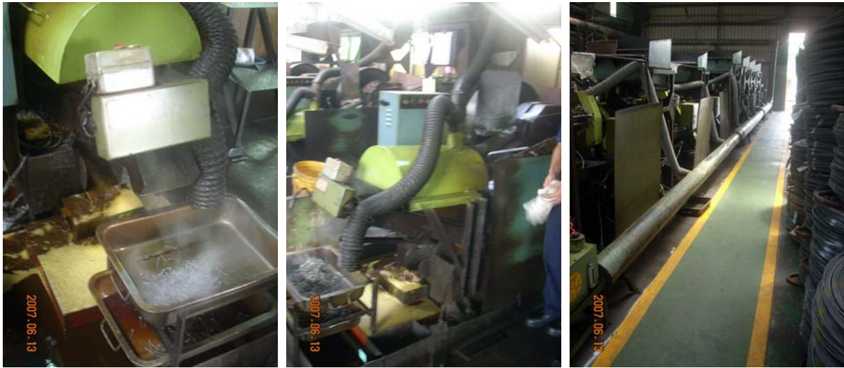
圖 3.17 夾尾機之局部排氣裝置
