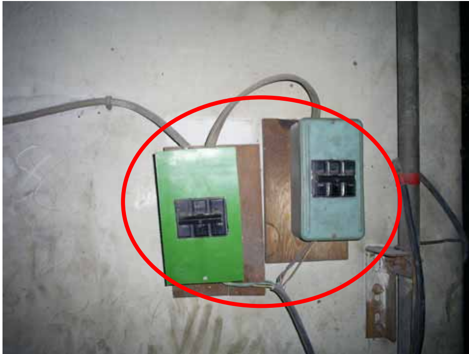
圖3.7 電氣開關用開關箱收容，防止勞工誤觸而感電
