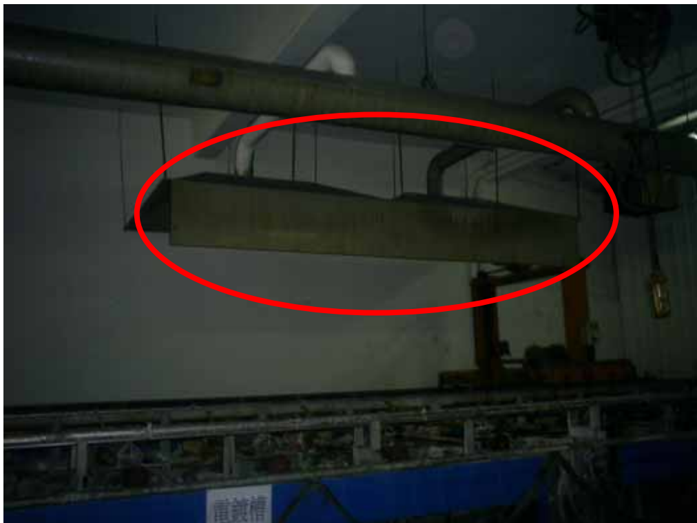
圖 3.5 電鍍槽裝設局部排氣裝置
